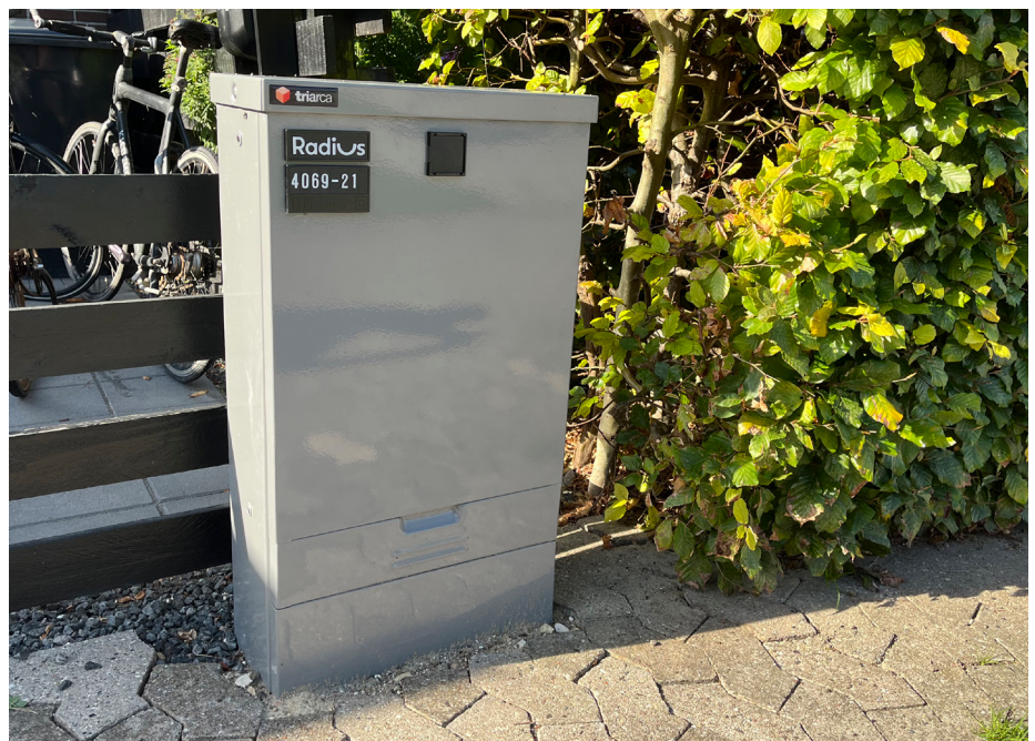
Et af de el-sikringsskabe der skal trækkes strøm fra.
